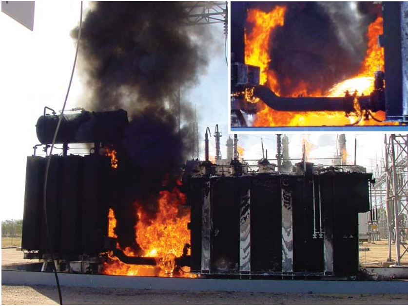
Пожар в трансформаторе 100 МВА в результате отказа кабельного присоединения 11 кВ.
