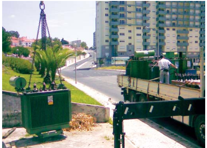
В целях удовлетворения требований по охране окружающей среды бригада демонтирует масляный трансформатор СН/НН с содержанием полихлорбифенила.
