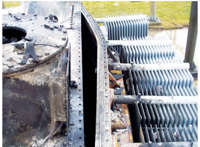
Отказ нижней секции этого ввода с бумажно-масляной изоляцией привёл к разрыву бака реактора и пожару.
