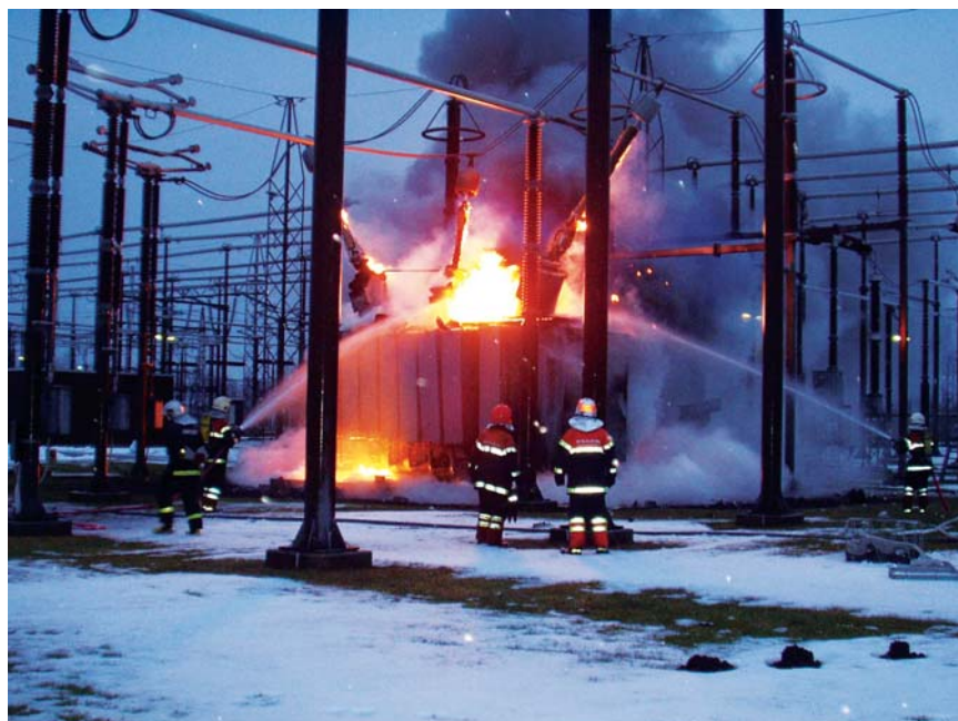
Отказ ввода с бумажно-масляной изоляцией на реакторе 400 кВ мощностью 100 МВАр привёл к пожару в реакторе.
