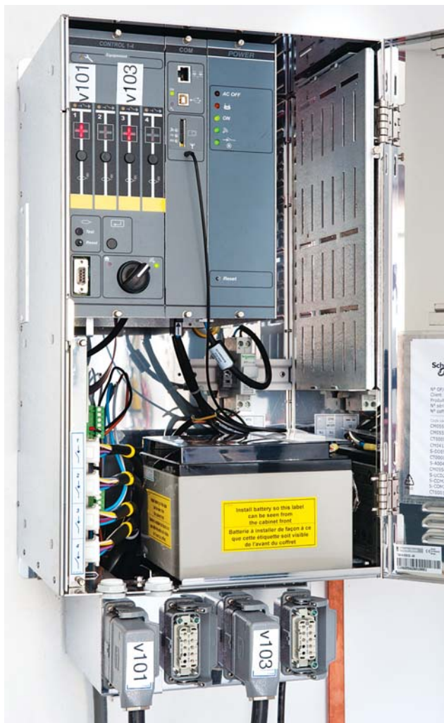
Внешний вид устройства T200 компании Schneider Electric с подключениями электроприводов, а также аккумулятора, модема и RTU.
