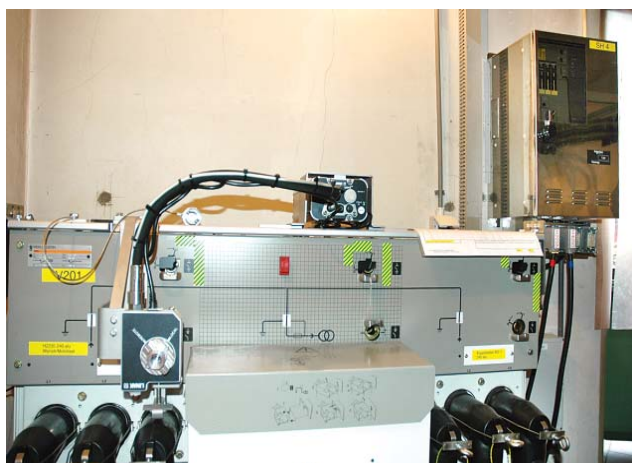
Общий вид размыкающей точки сети (показан электропривод LINAK).
