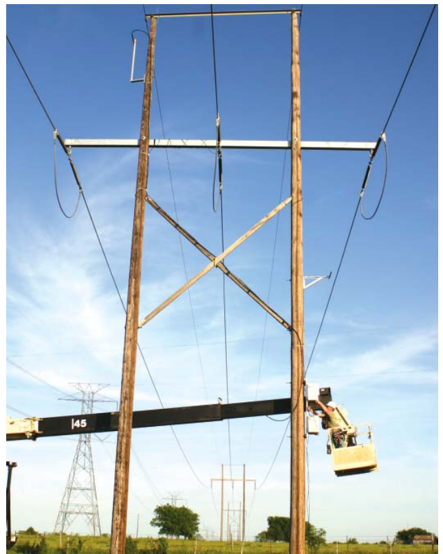
Рис. 5. Линейный рабочий подключает систему мониторинга с датчиками тяжения и окружающей среды на П-образной опоре.
