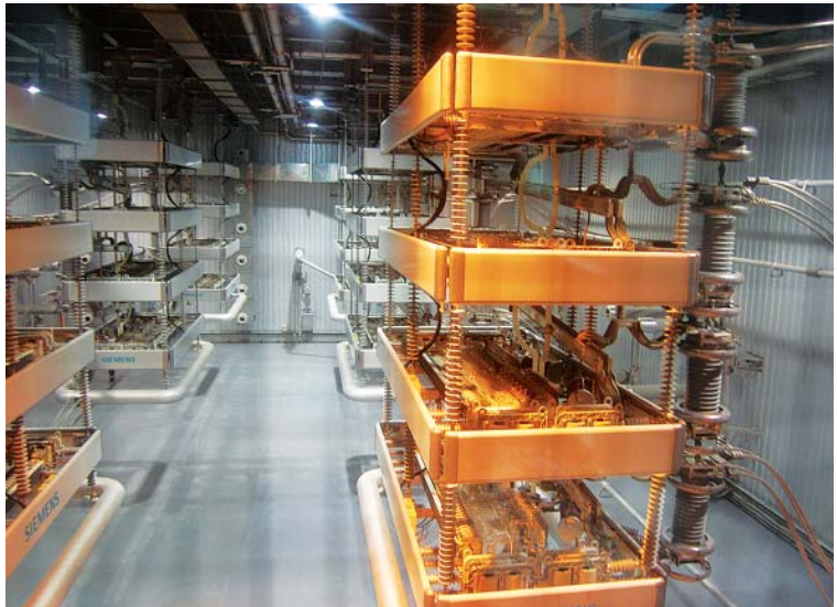
Вентильный зал вставки постоянного тока 500 МВт системы HVDC.
