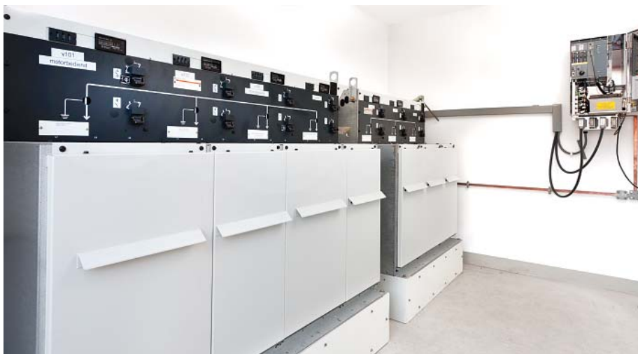
Распределительная подстанция 23 кВ с высоковольтным распределительным устройством и устройством Schneider Electric T200 в навесном исполнении.
