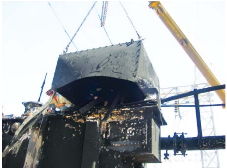
При отказе кабельного ввода 11 кВ произошёл разрыв соединительной пластины и разлом ввода; разлившееся масло загорелось, произошёл серьёзный пожар.
